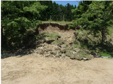
【グラウンド北側のり面の崩落】
