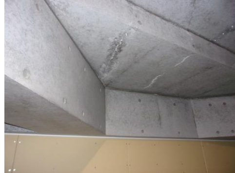
【体育館ステージ袖の雨漏り跡】
